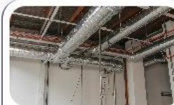
تأسیسات برق و مکانیک
